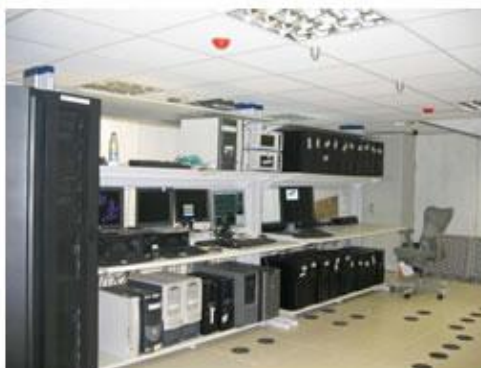
Sala de Scada Cabeamento Cat.6 Redundante
