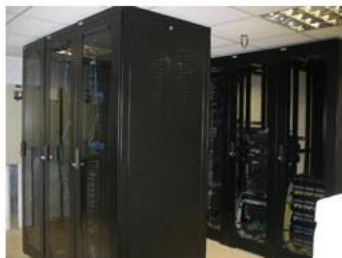
Sala de Servidor Cabeamento Ótico
