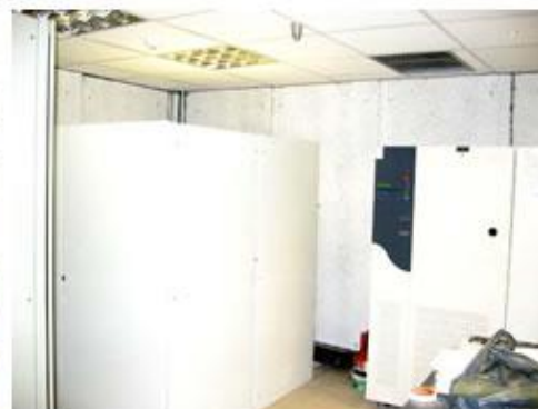
Sala de No-Break Redundante
